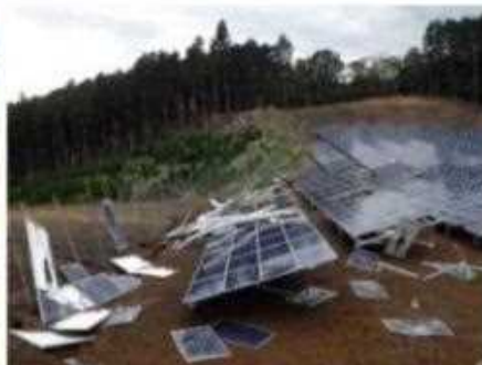
【図2】 台風の強風による事故被害
