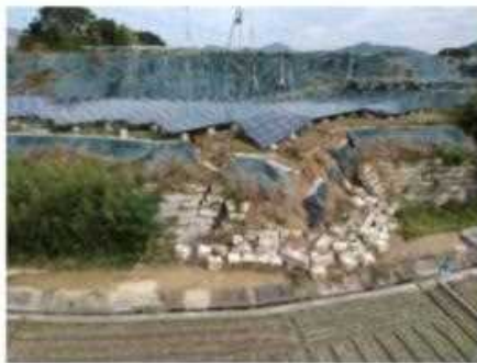
【図1】 台風の大雨による事故被害
