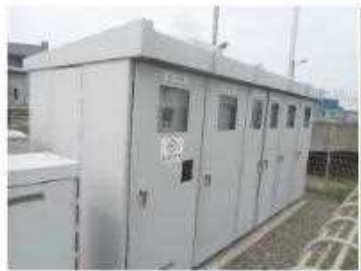
キュービクル（高圧受電設備）
