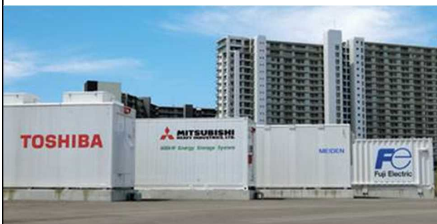
図1 定置用蓄電池システムの一例
