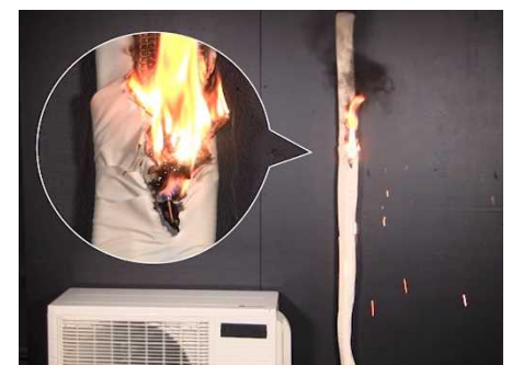
エアコン配線の途中接続部から発火
