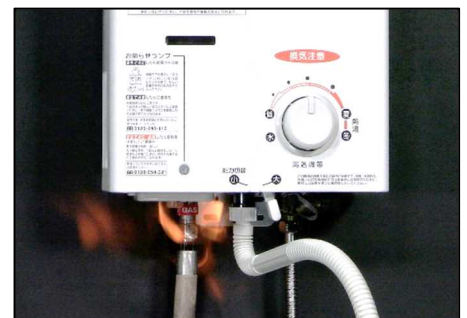
ガス瞬間湯沸器のガス接続部から漏れたガスに引火
