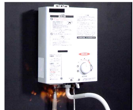
中古ガス瞬間湯沸器の接続部から漏れたガスに引火（不適切な設置工事の再現実験）
