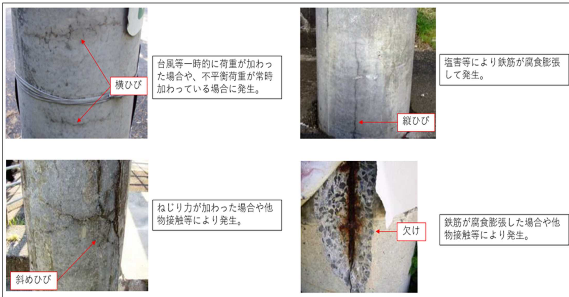
図4 鉄筋コンクリート柱のひび割れ例 (大日コンクリート工業株式会社「コンクリートポール 点検手引書」より写真を引用)
