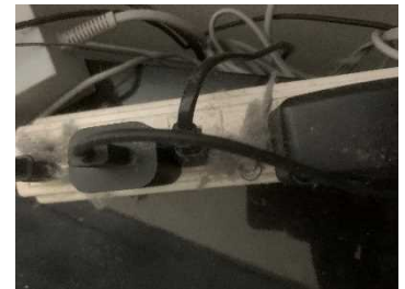
ほこりで汚れたテーブルタップ
