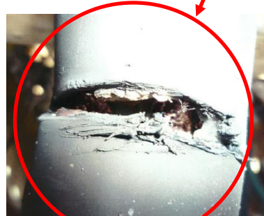
誤切断ケーブル拡大
