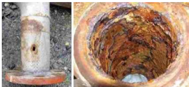
図1 微生物による鉄腐食の事例
