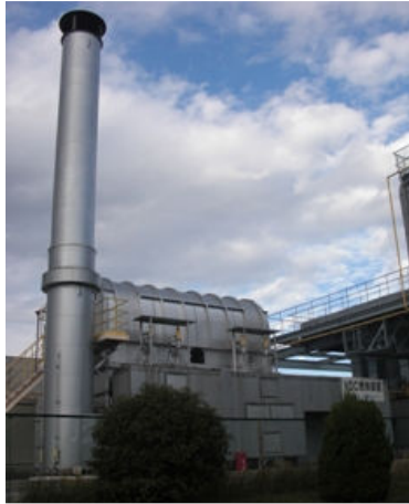
蓄熱燃焼装置
